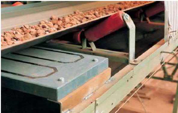
Metalldetektor QLC als Einzelsonde unter dem Förderband montiert.
