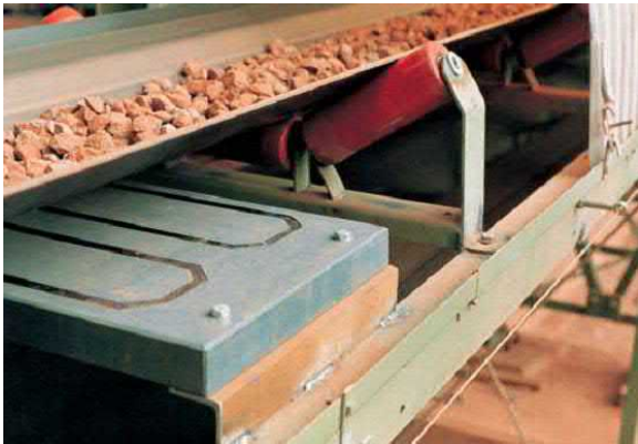
Metalldetektor QLC als Einzelsonde unter dem Förderband montiert.
